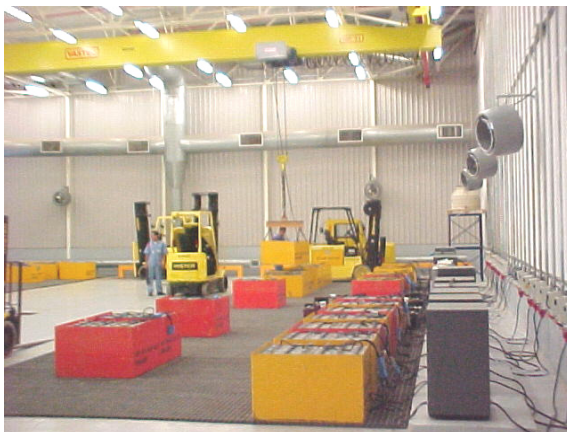
CALOR: Ar condicionado e ventiladores climatizadores
